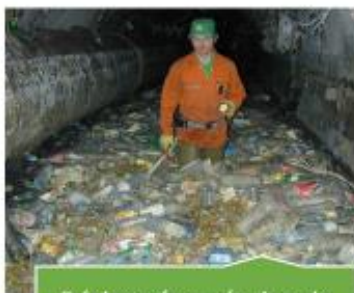
Déchets évacués dans le pluvial
