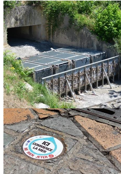
En haut : système de filtration en sortie d'exutoire d'eau pluviale (Draguignan)
