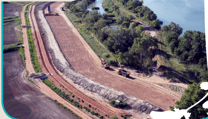
Travaux 2015 au sud d'Arles > conservation de la ripisylve, restauration de zones humides : allier la sûreté des ouvrages et l'environnement, tel est l'objectif du démontage des digues trop proches du fleuve (à droite) et leur reconstruction (à gauche) en recul du fleuve.
